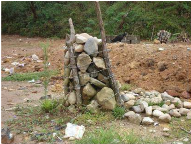
Foto 7 Filtro para la evacuación de gases (chimeneas)
